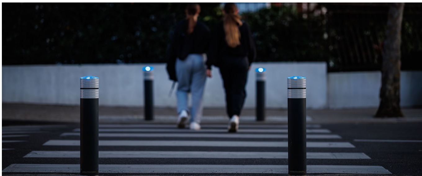
Protection d'un passage piéton par des poteaux solaires flexibles. Photographie : Nathanaël Mergui
